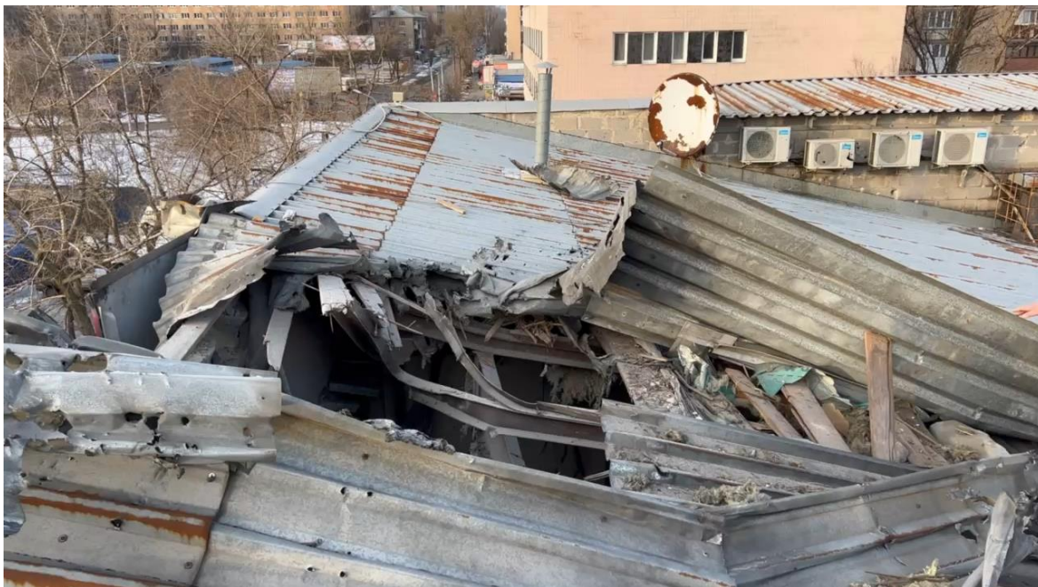
Рис. 27 – Попадание снаряда в кровлю здания по ул. 50-летия СССР, 151 «в» 37 .
