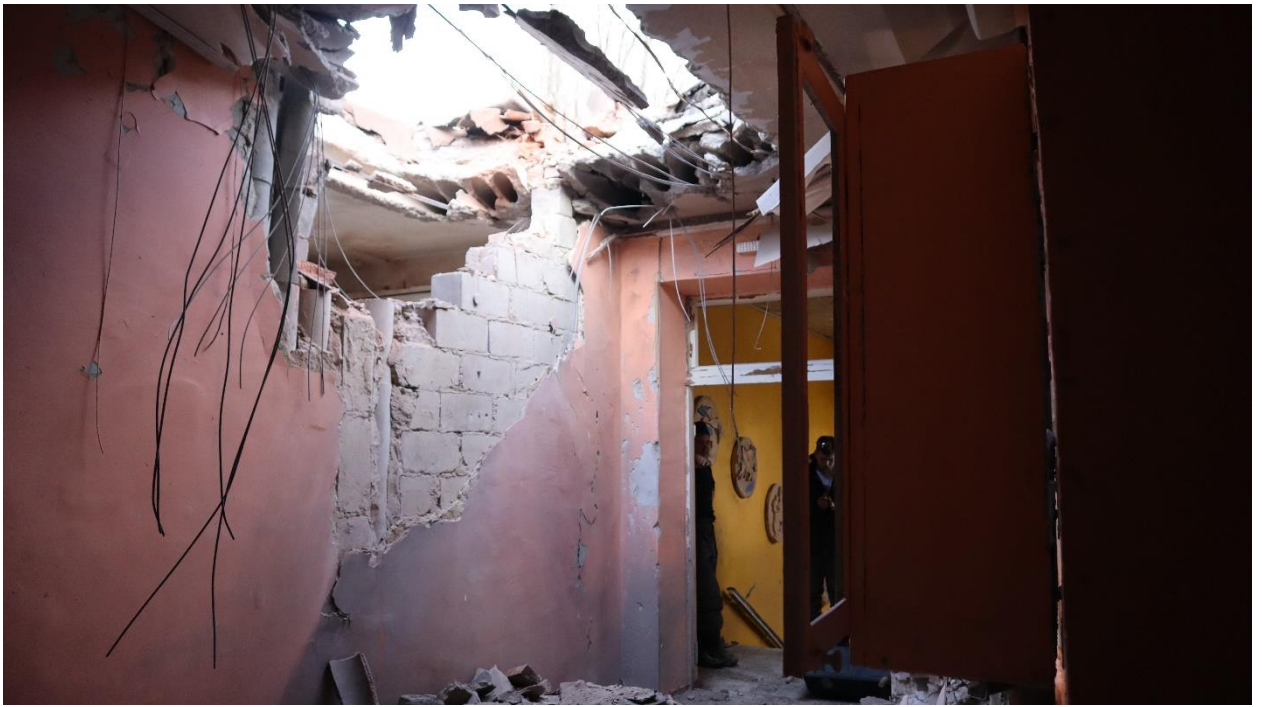
Рис. 28 – Попадание снаряда в кровлю здания ясли-сада № 294 по ул. 50-летия СССР, 151 «а».
