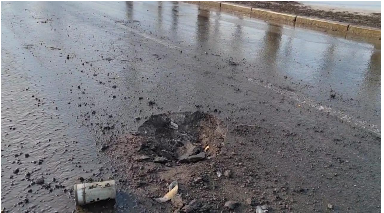
Рис. 6 – Попадание снаряда в асфальтовое покрытие по пр. Мира 29 .
