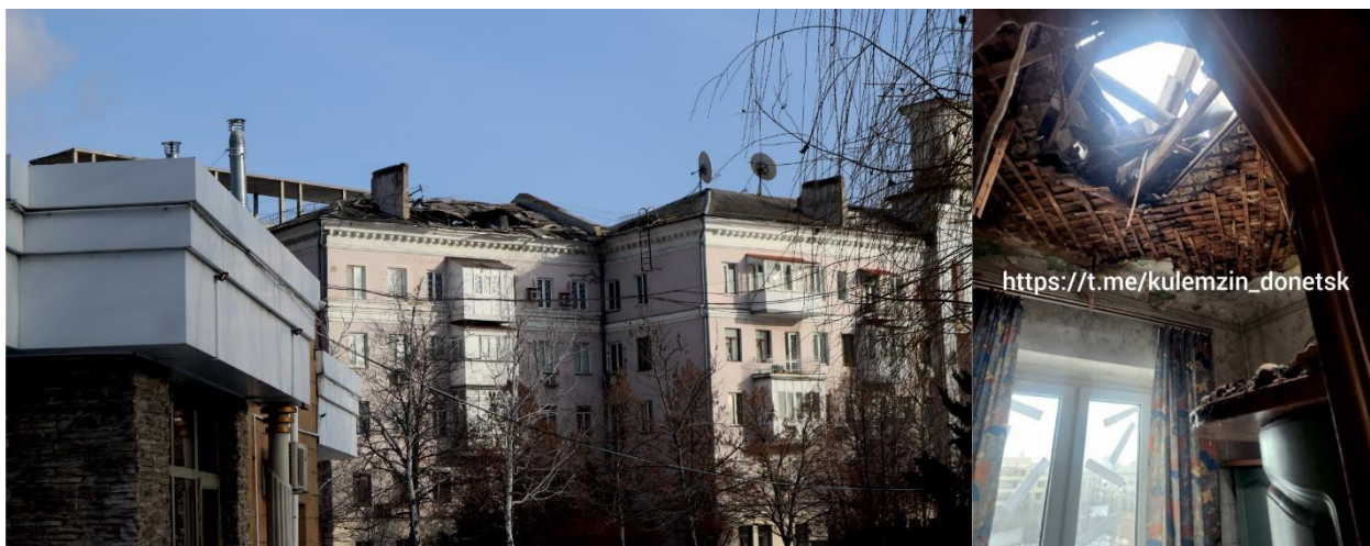
Рис. 32 – Попадание снаряда в кровлю многоквартирного жилого дома по ул. Артема, 86 «а» (фото справа: вид снаружи, фото слева 38 : вид изнутри).
