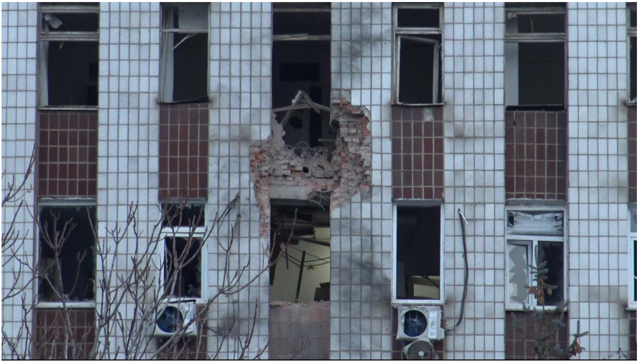
Рис. 18 – Попадание снаряда в многоэтажное здание по ул. Челюскинцев, 167 «а».
