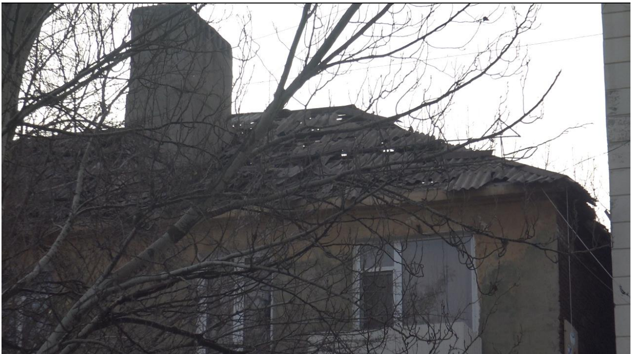
Рис. 45 – Попадание снаряда в кровлю многоэтажного жилого дома по ул. Горького, 158.
