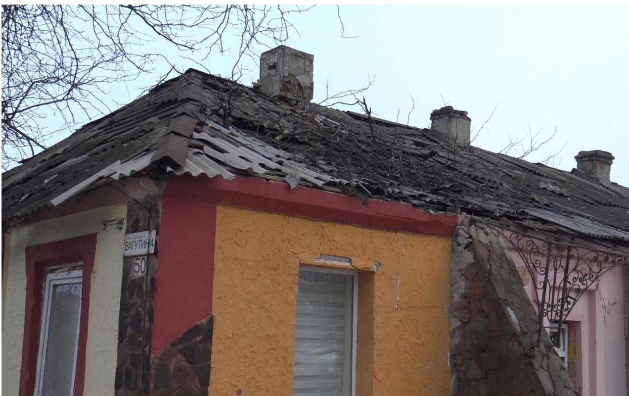
Рис. 11 – Попадание снаряда в жилой дом по ул. Ватутина, 50.
