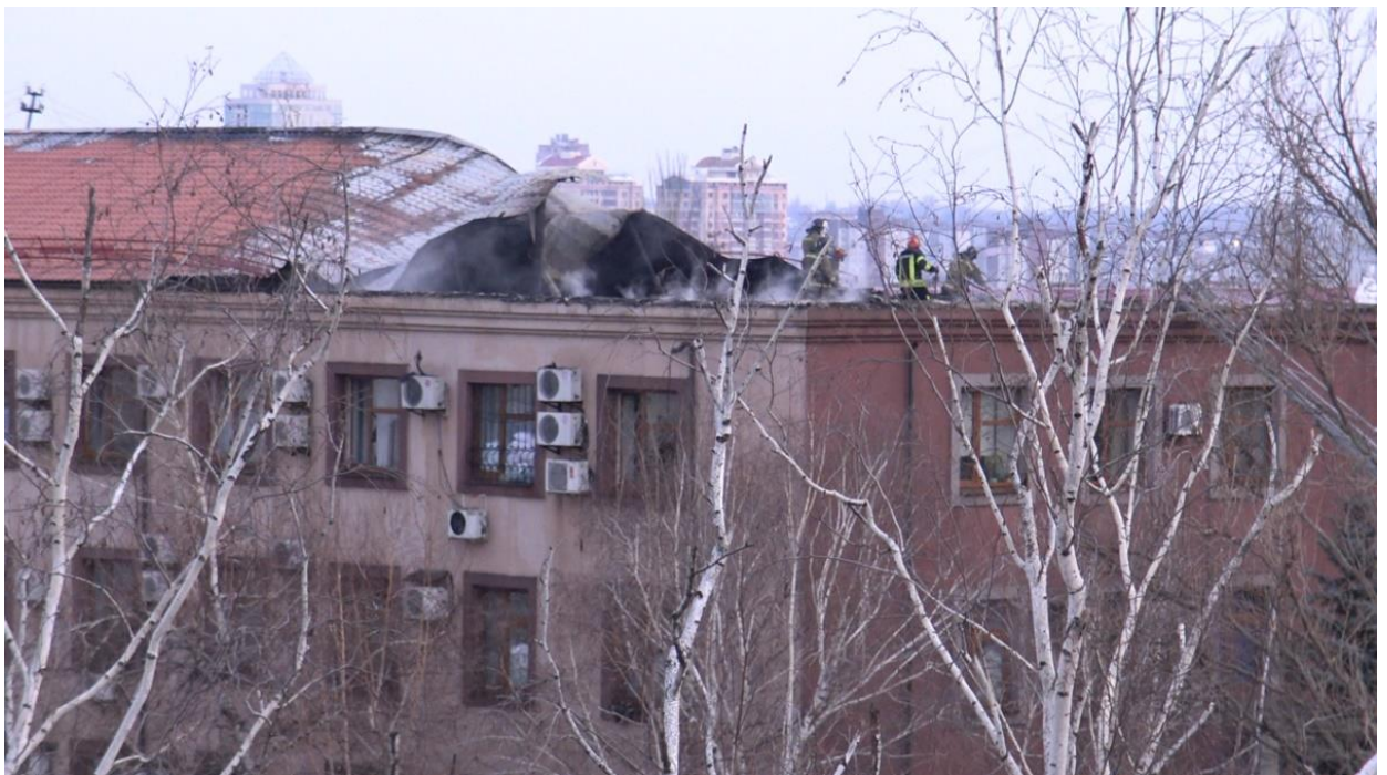
Рис. 19 – Попадание снаряда в кровлю здания Прокуратуры Донецкой Народной Республики по ул. Генерала Антонова, 2.
