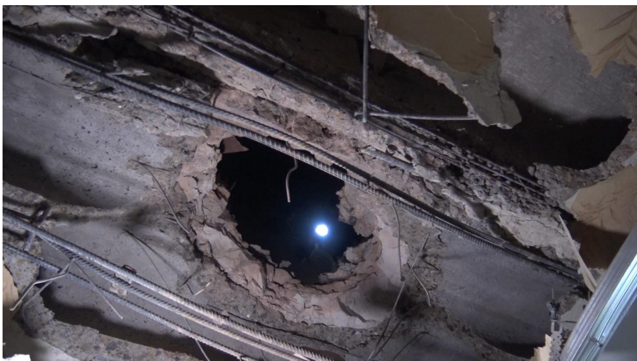
Рис. 47 – Попадание снаряда в жилой многоквартирный дом по ул. Челюскинцев, 184.
