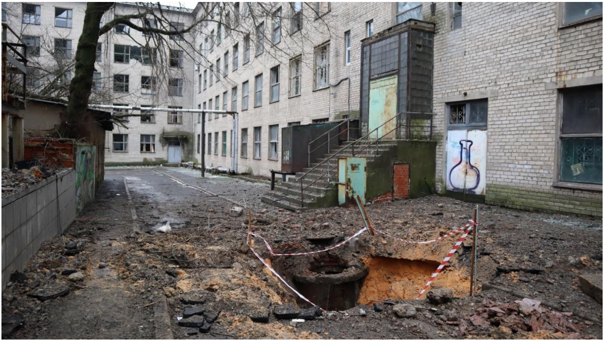
Рис. 22 – Попадание снаряда в канализационный колодец рядом с корпусом № 7 Донецкого национального технического университета по пр. Богдана Хмельницкого, 106.
