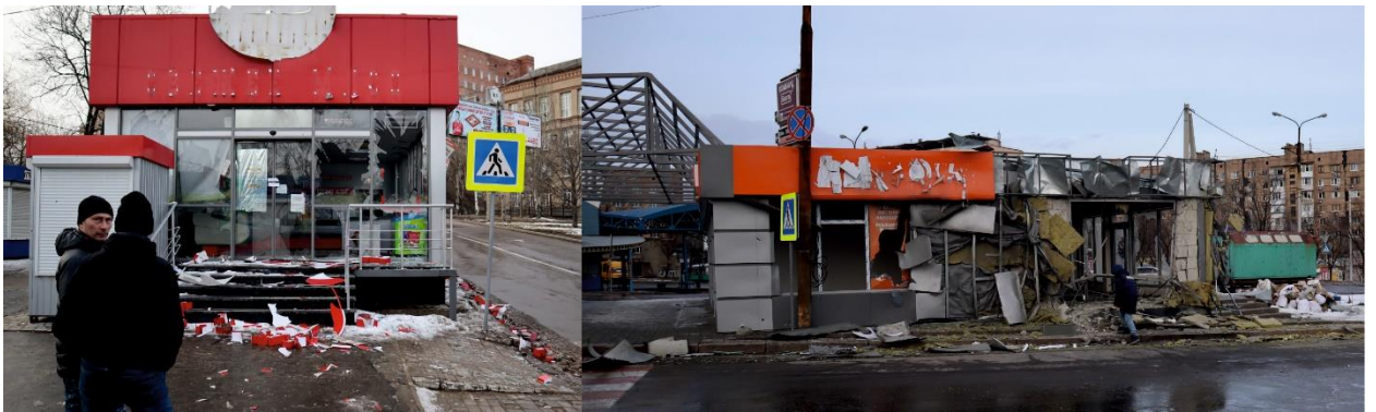
Рис. 25 – Поврежденные торговые точки по пр. Богдана Хмельницкого на рынке «Центральный».
