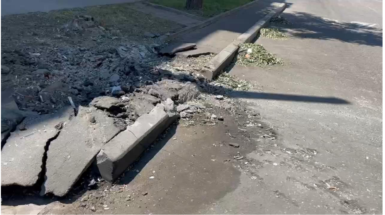
Рис. 6 - Последствия детонации снаряда перед зданием по улице Ватутина 22. 18
