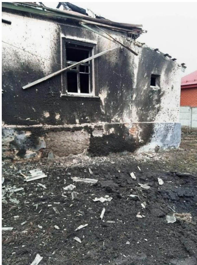
Рис. 6 – Последствия взрыва артиллерийского снаряда на территории домовладения по адресу улица Плеханова, д. 3.
