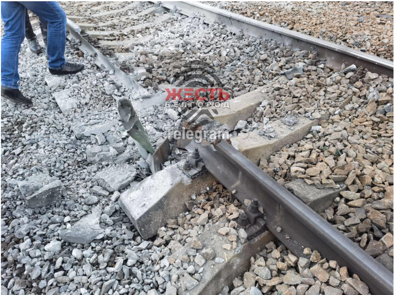
Рис. 2 – Последствия детонации снаряда в железнодорожном полотне. 15
