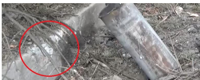
Рис. 20 - поврежденный участок бордюра по ул. 50 лет образования СССР 24 .
