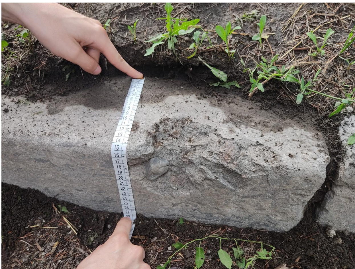
Рис. 21 - Измерение ширины и высоты видимой части бордюра; справа от гибкой рулетки – тот самый поврежденный участок бордюра вследствие взрыва снаряда.
