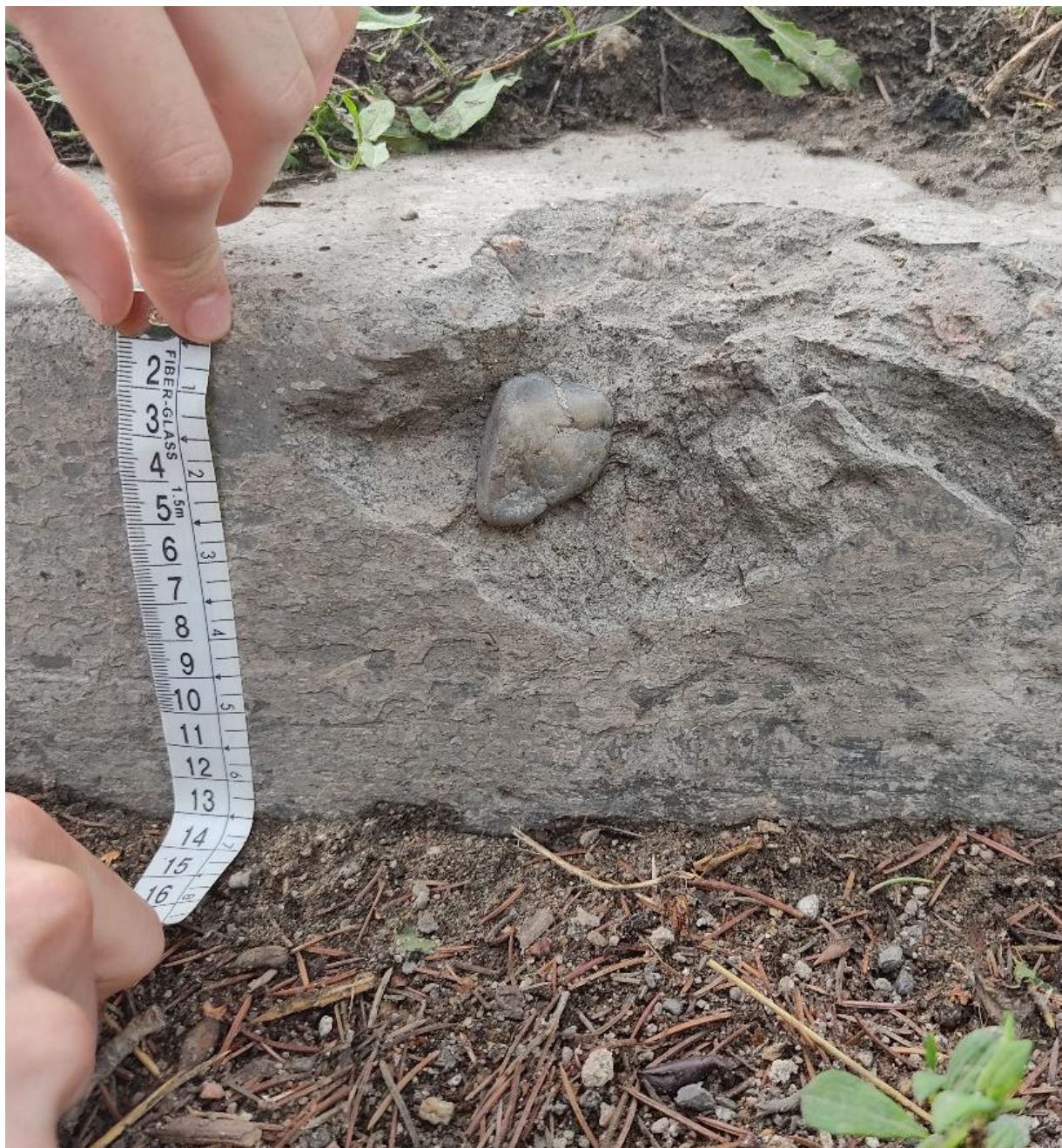
Рис. 23 – измерение высоты бордюра рядом со следами от взрыва снаряда по улице 50 лет образования СССР напротив дома по адресу квартал Северный, 12.
