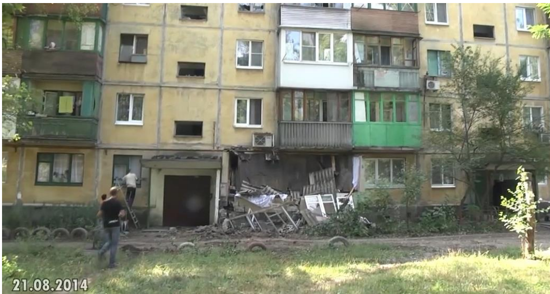
Рис. 11 - Попадание (№10) в северную стену дома по адресу квартал гвардейский 13 на уровне первого этажа 13 .
